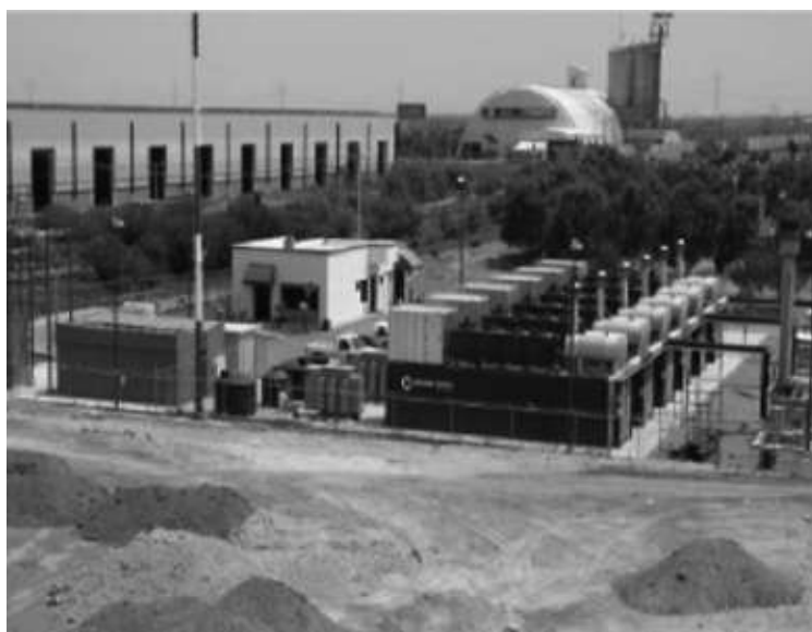
Figura 4. Instalaciones para la recuperación de metano de un relleno sanitario en Nuevo León.
